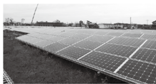
当社が受注した太陽光発電設備
